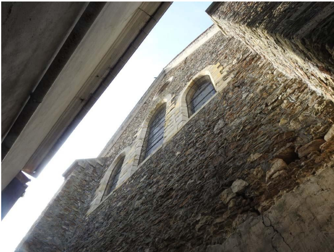
Façade est de l'édifice, enduits altérés, moellons de pierres déjointoyés, Fissures, pierres calcaires pulvérulentes, bandeau de rive dégradé, présence de mousse et de lichen
