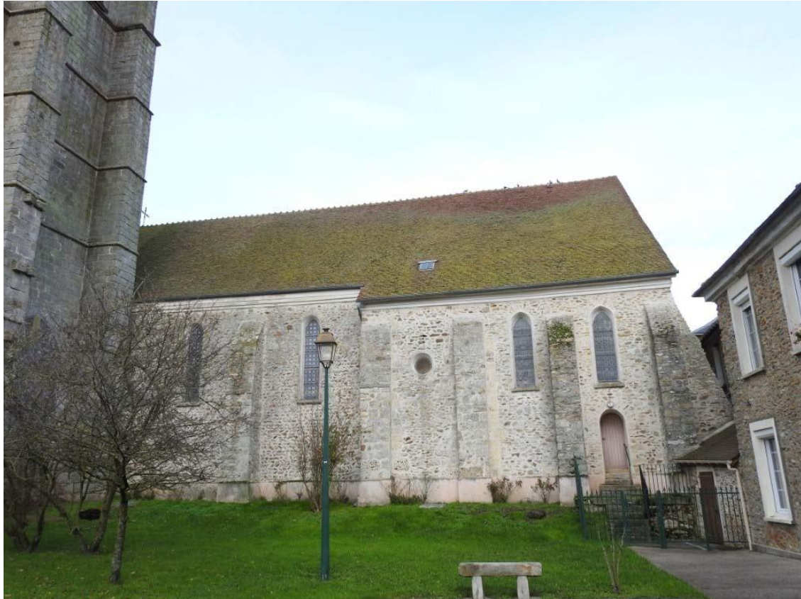
Couverture de la nef et du chœur altérée, tuiles ponctuellement manquantes et brisées, tuiles poreuses
