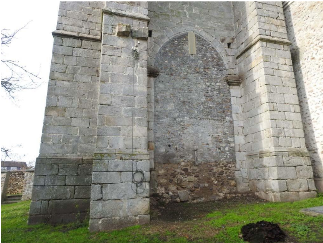
Détail de la façade est du clocher, pierres appareillées déjointoyées, présence de mousse et de lichen
